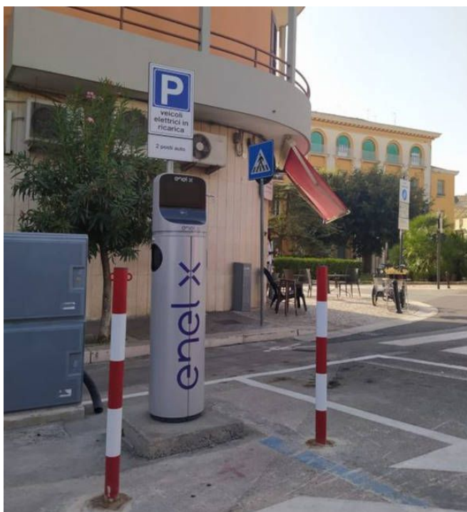
Figura 35La prima colonnina di ricarica installata a Matera (Fonte Matera News)
